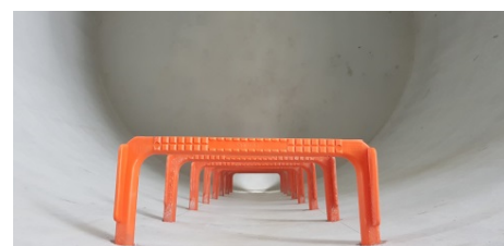
Pumpenschacht DN2500 mit Steigbügel (Edelstahl PP-Ummantelt)
