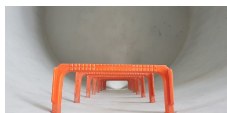
Pumpenschacht DN2500 mit Steigbügel (Edelstahl PP-Ummantelt)
